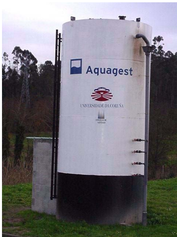
Dixestor UASB situado en A Silvouta, Santiago de Compostela.
