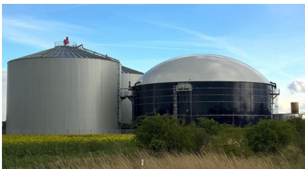
Planta de biogás
