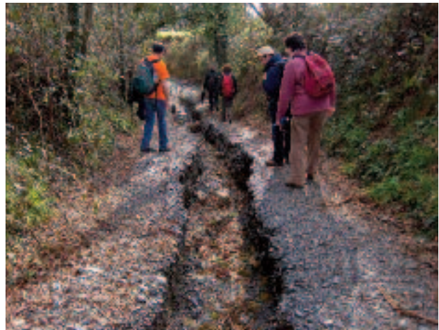
O abandono das calzadas históricas acelera o seu deterioro.
