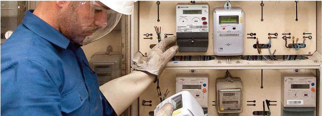
Técnico especializado comprobando o funcionamento de contadores eléctricos.
