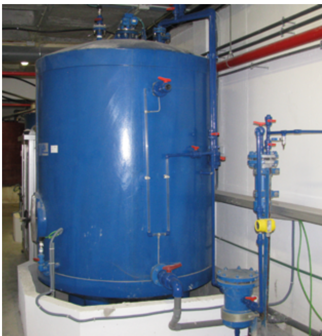
Planta piloto de tratamento descentralizado do proxecto R4L, instalado no edificio do Centro de Negocios de Porto do Molle.
