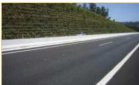
Cuberta vexetal na Autovía AG-56.
