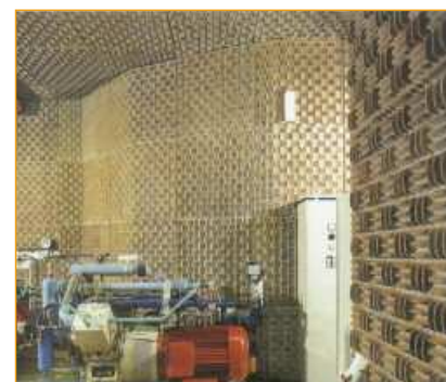
Sala de máquinas revestida de absorbentes acústicos de espuma branca de poliuretano.
