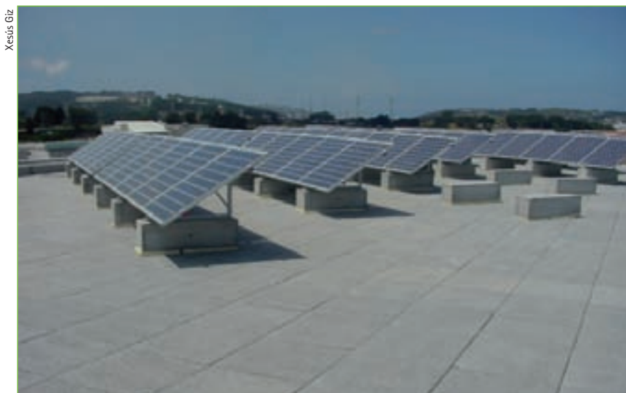
Instalación fotovoltaica no CITIC (Universidade da Coruña). A enerxía renovábel contrasta coa enerxía fósil (ao fondo, a refinaría de petróleo).
