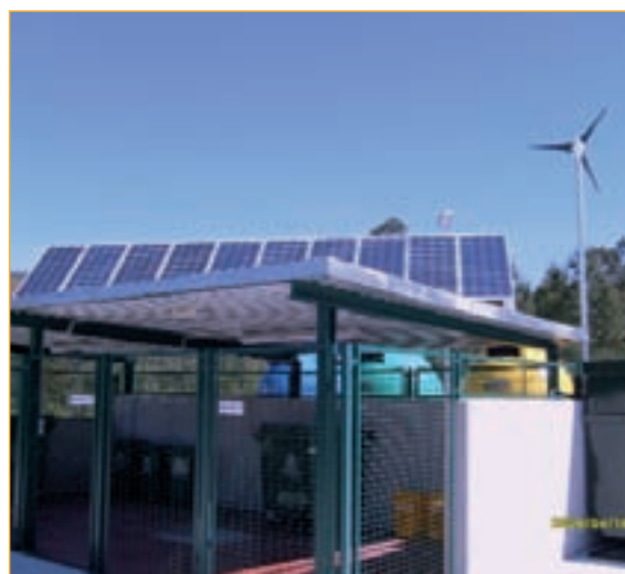
O punto limpo de Muros é autosuficiente enerxeticamente.
