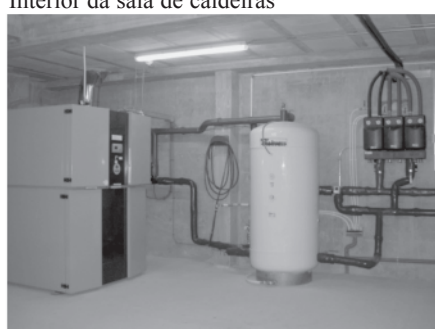
Interior da sala de caldeiras
