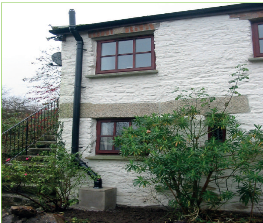
Gráfico 3: Extracción do aire do subsolo nunha casa. A cheminea arranca dunha arqueta de succión escavada por baixo do soto ou do andar máis baixo do edificio e ascende ben polo interior, ben polo exterior como é o caso na fotografía, até o tellado.
