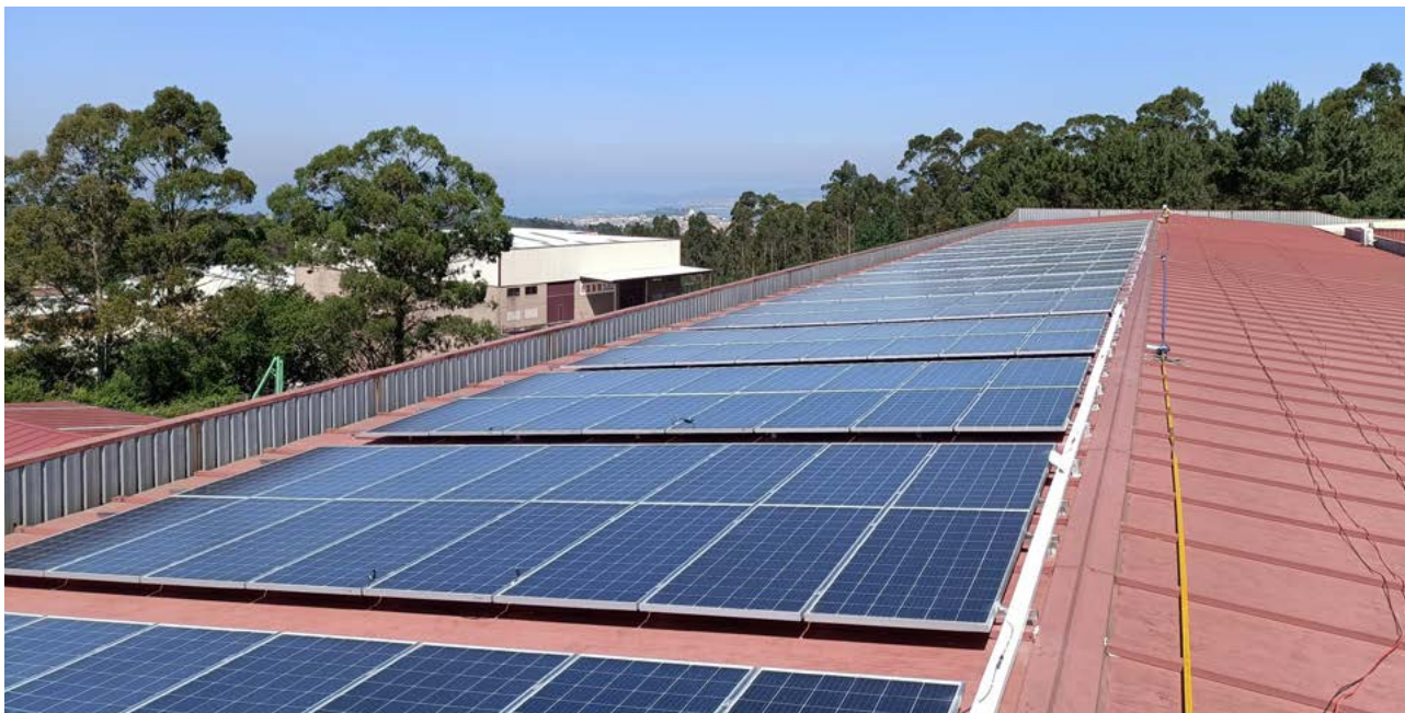
Cuberta con paneis solares nunha das naves da Comunidade de Montes de Tameiga · Comunidade de Montes de Tameiga.
